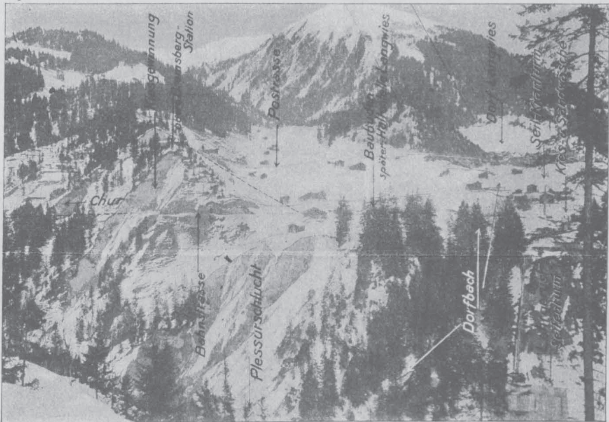
Fig. 26. Ansicht der rechten Talseite bei der Brückenstelle mit Anordnung der Baueinrichtungen. Bauzustand am 15. Februar 1913.
